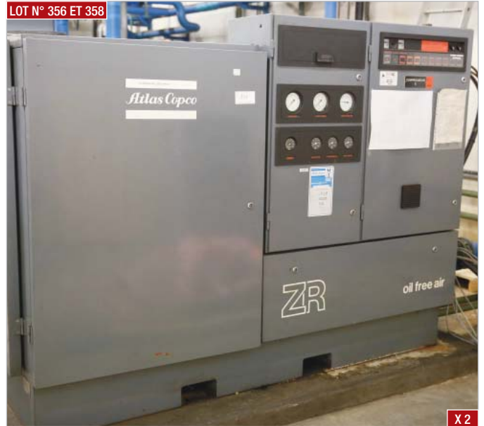
► Compresseur à vis ATLAS COPCO ZR3M ► ATLAS COPCO ZR3M screw compressor
